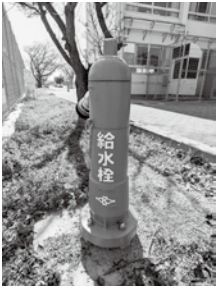
非常時給水栓
