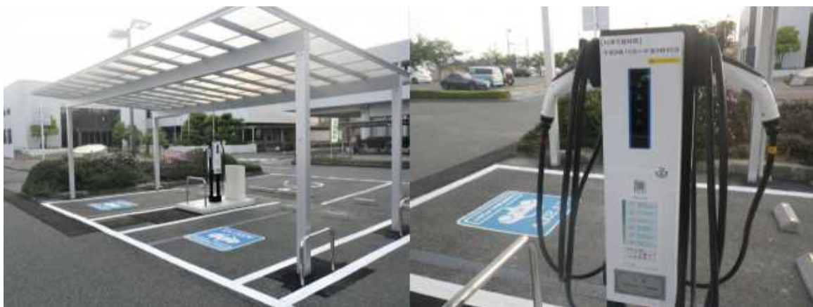
図 4-12 役場駐車場の電気自動車（EV）用普通充電器 （出典：播磨町ホームページ）
